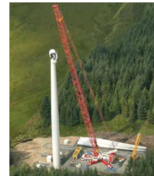
Монтаж турбины с помощью тяжелого передвижного крана, установленного на платформе с применением технологии Тенсар (Hadyard Hill, Шотландия).
